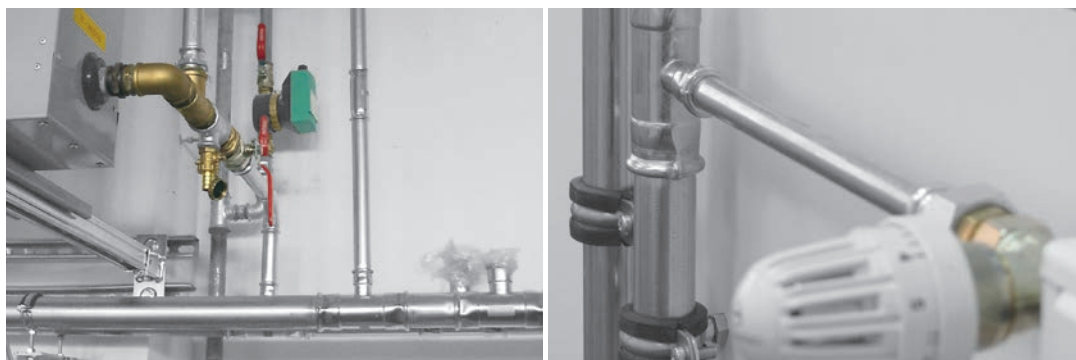
Примеры монтажа оборудования KAN-therm Steel
